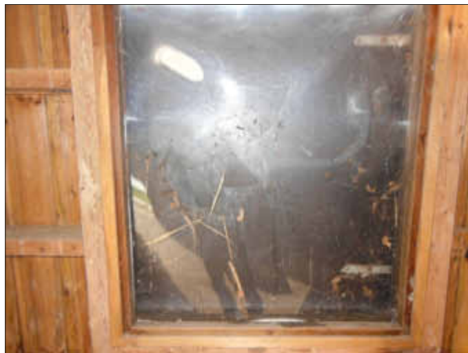
Die zerstörte Fensterscheibe in der Angelhütte
