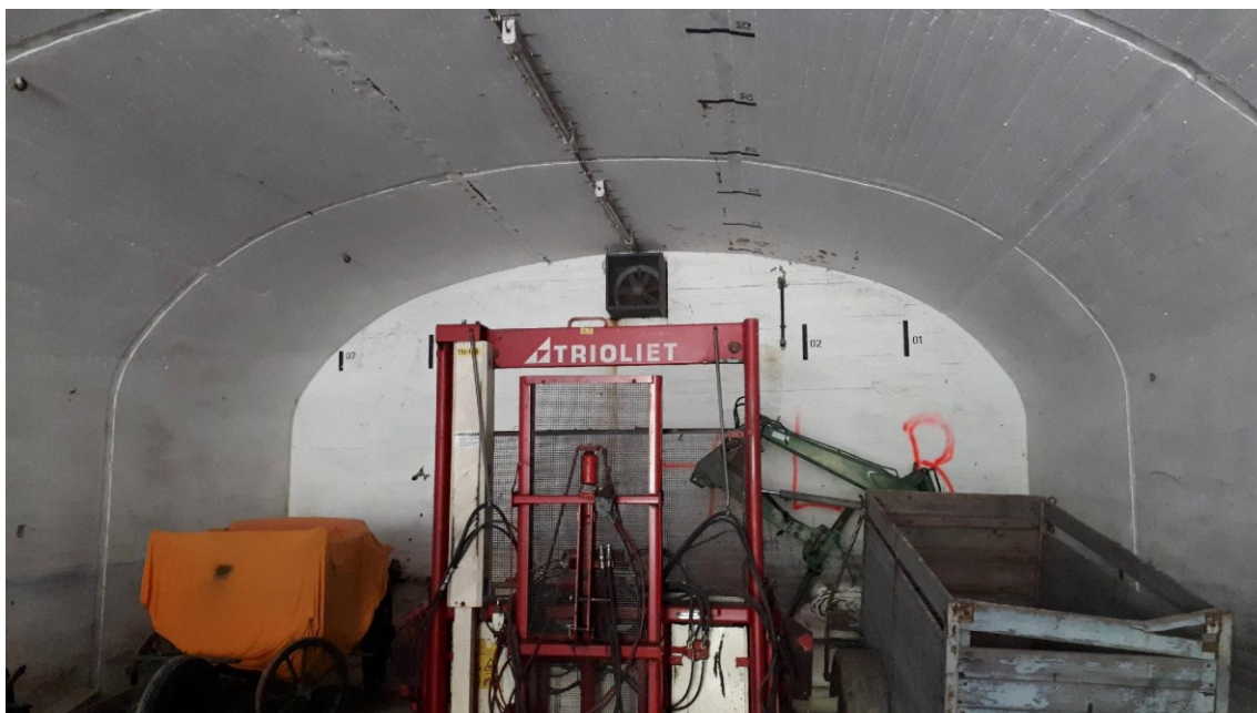
Abb. 3: Blick in einen offenen Bunker des Typs 200 mit Betonmauern, Lichtleiste an der Decke und intakter Lüftung an der hinteren Wand (Foto: C. Grave)
