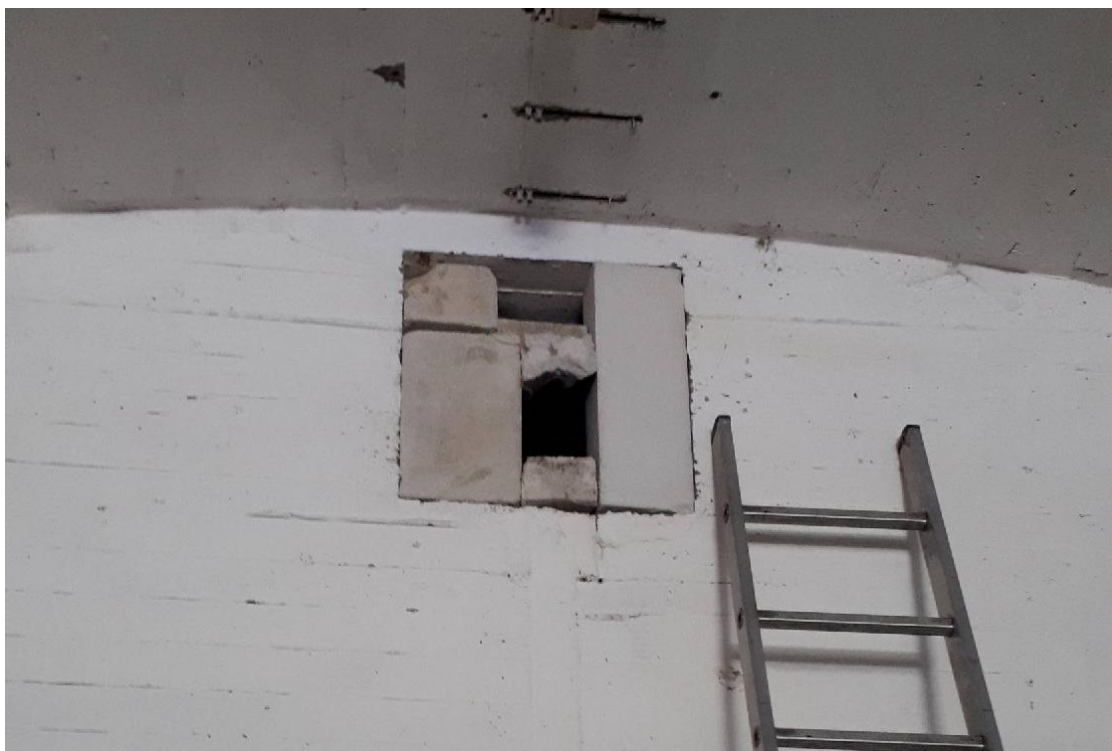
Abb. 4: Blick auf eine kaputte Lüftung in Bunker 45, durch diese Lüftung zog ein kalter Luftzug, im Lüftungsschacht hatte sich am Boden Wasser gesammelt (Foto: C. Grave)
